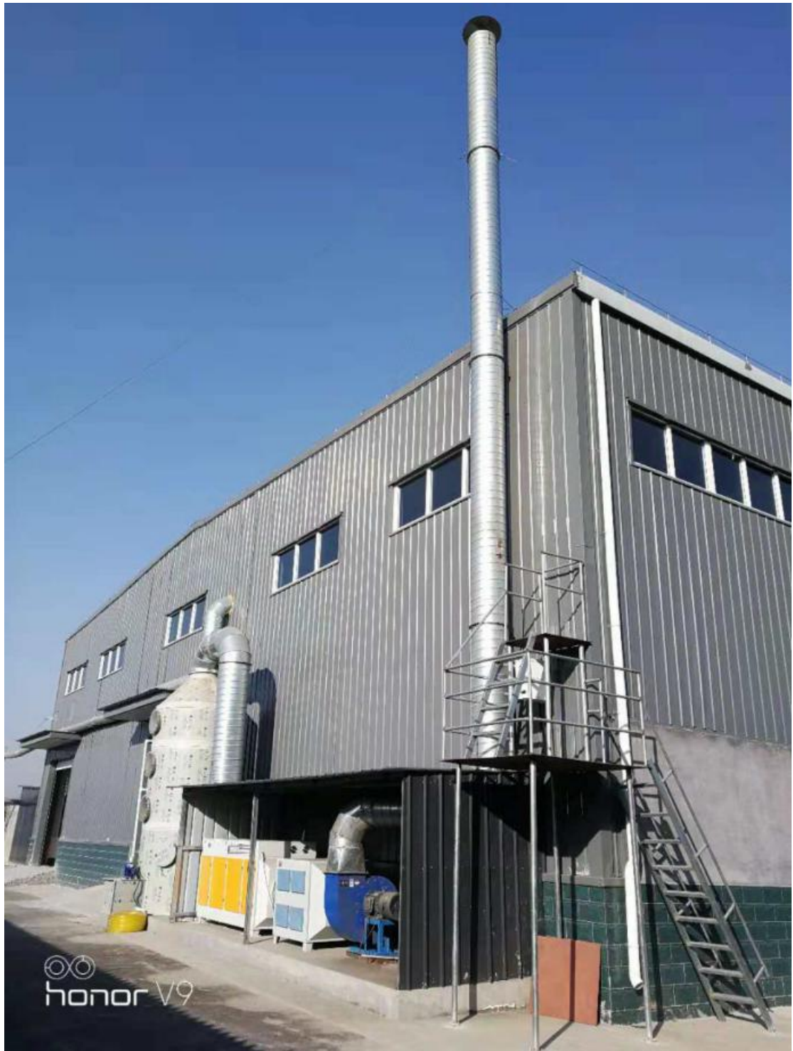
废气综合处理系统（除臭喷淋+光氧催化+活性炭吸附+15m 高排气筒）
