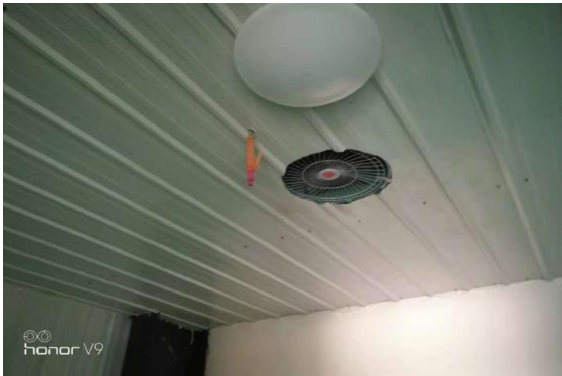
暂存间废气负压收集孔
