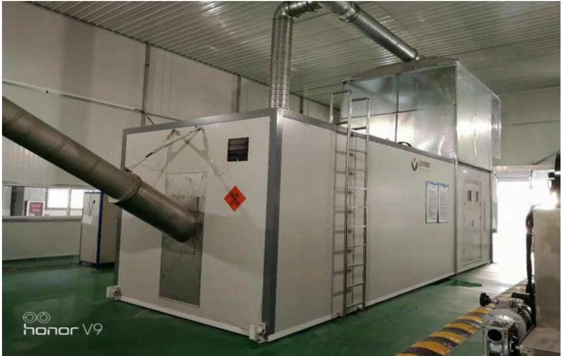
医废微波消毒处理设备废气收集管路
