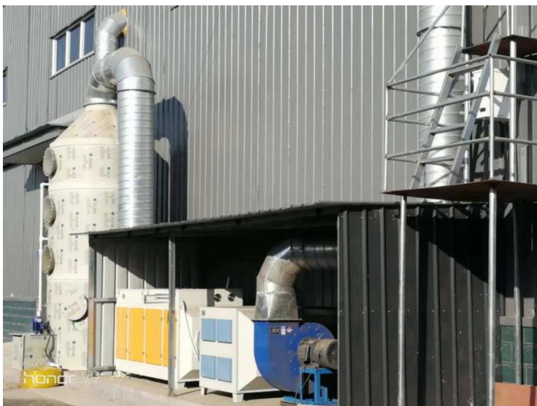
废气综合处理系统（除臭喷淋+光氧催化+活性炭吸附）
