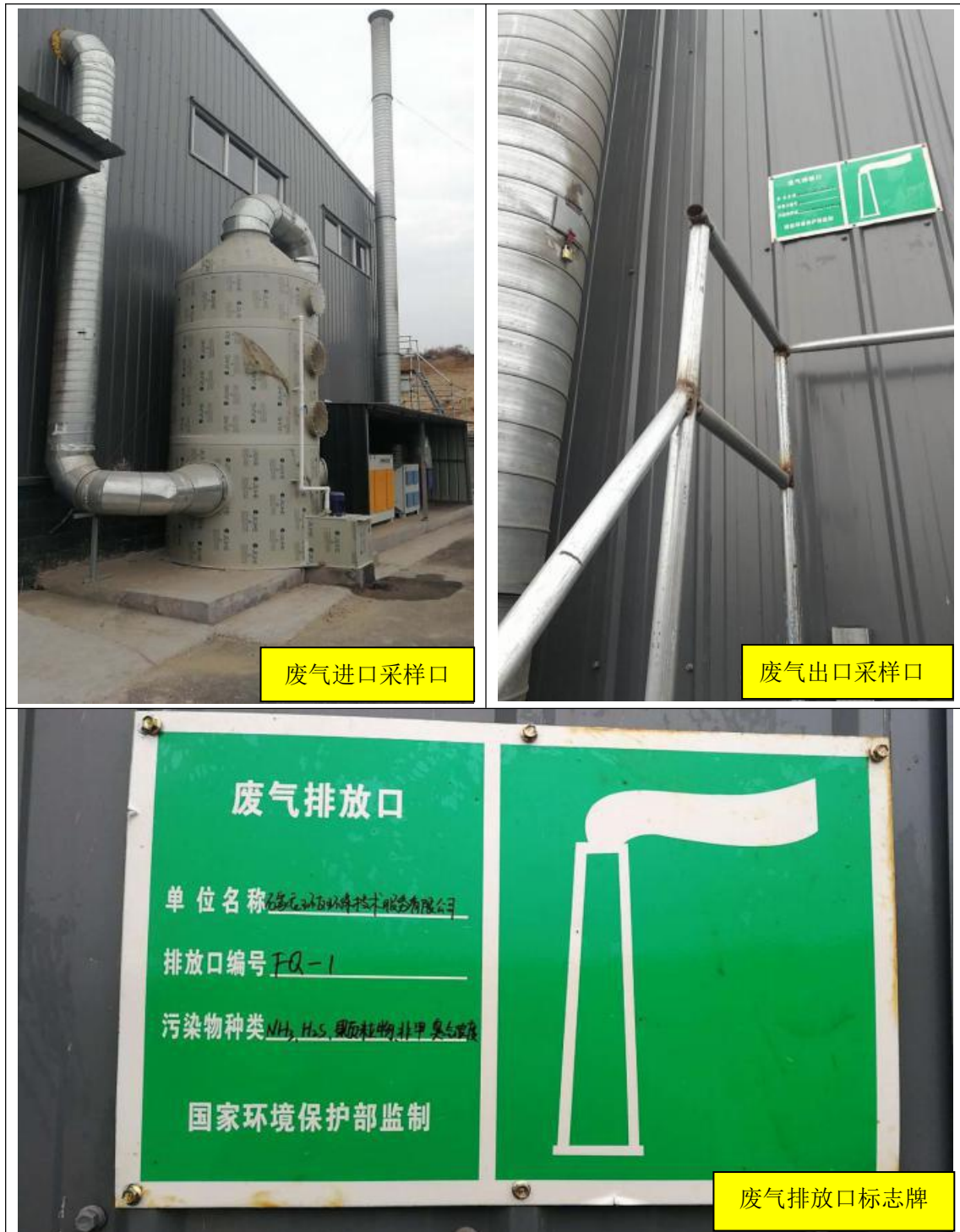
图 4-6 规范化排污口、监测设施现场图
