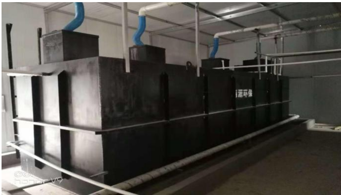
污水一体化处理设备
