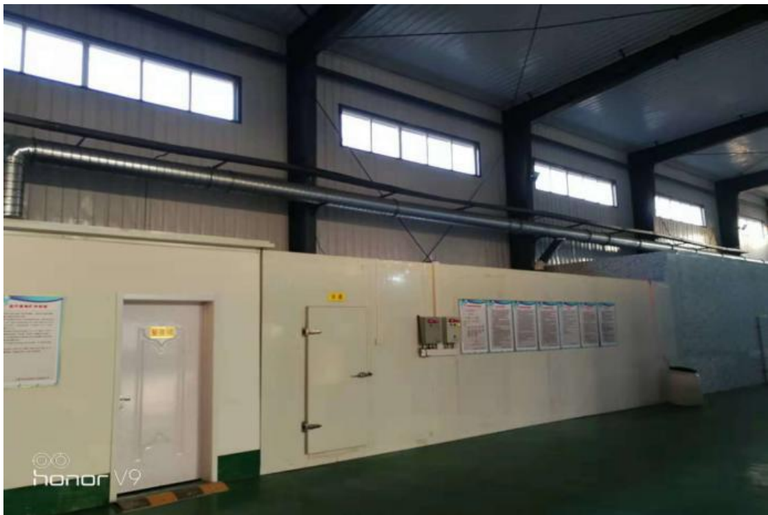
暂存间废气收集管路
