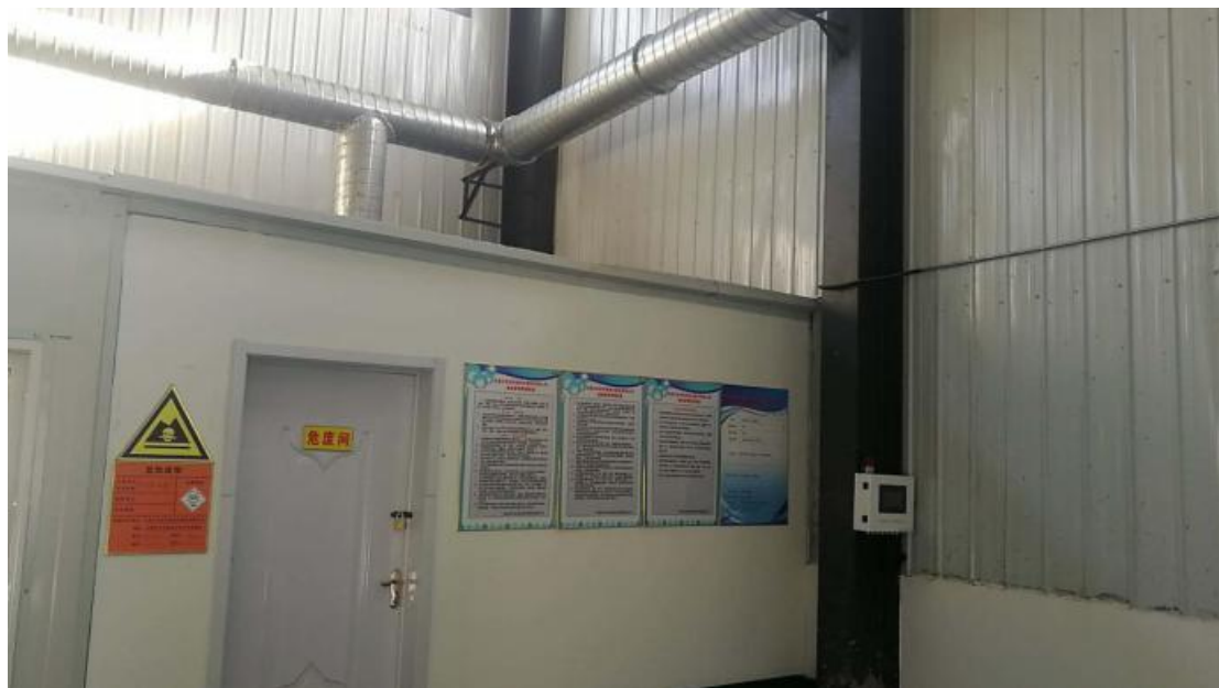
危废暂存间外部及危废暂存间废气收集管路
