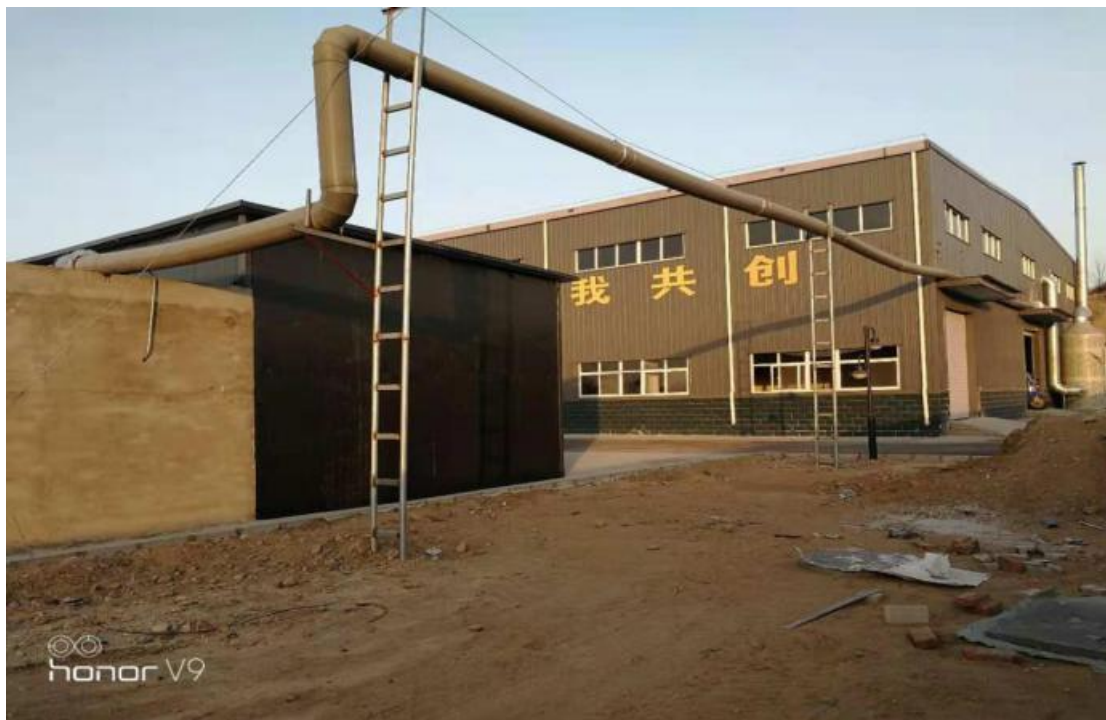
污水处理站废气收集管路
