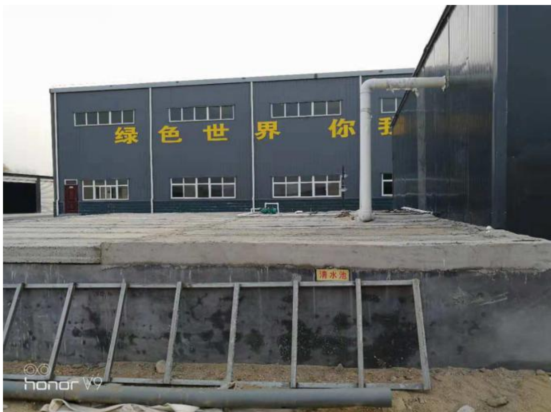
污水处理站清水池
